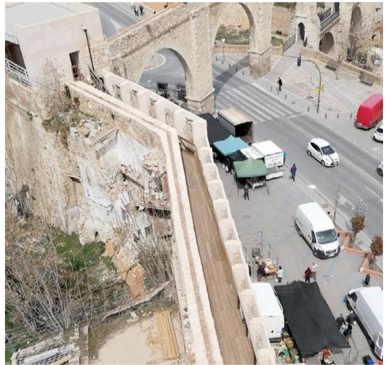
Estado en el que se encuentra la parte interior de la muralla
